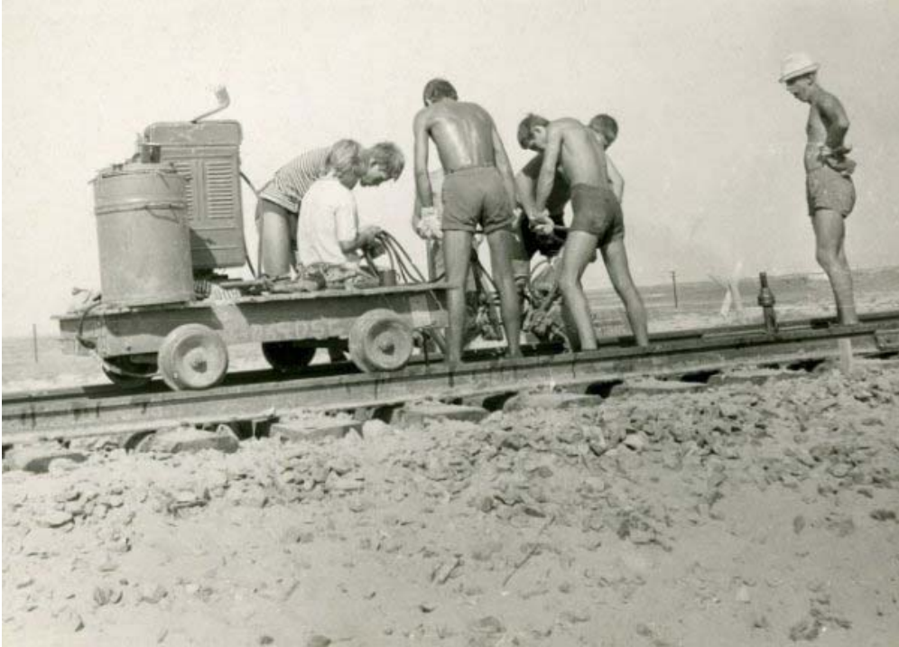
07. Шпалоподбойками трамбуем балласт. Алена Федорова-Коваль руководит проводами. На снимке: Володя Комаров, Валера Федоров, Володя Пискунов, трудновоспитуемый Бобров (Бобер), Толя Тюнис.
